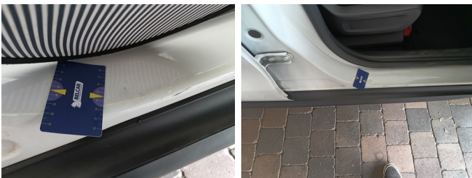
Onderkant R - Drempel R - Deuk - Spotrepair
