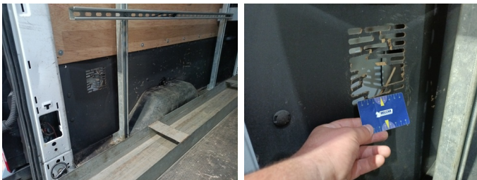
INT achteraan - Bekleding koffer L - Gebarsten - Vervangen
